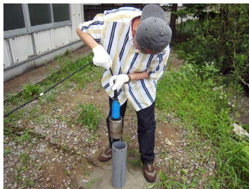
3成分MEMS地震計のキー溝方式による設置
